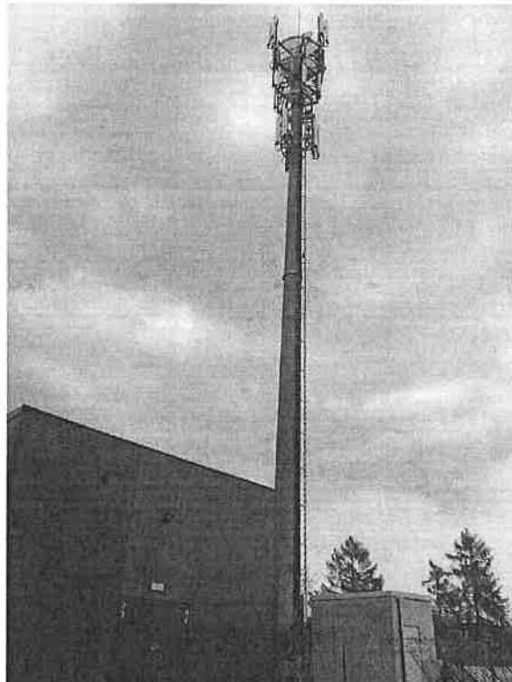
Zał. nr 1: Widok ogólny instalacji radiokomunikacyjnej.
